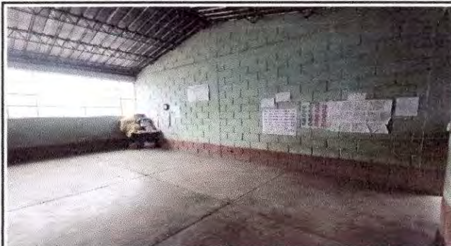
Foto 14: Estado actual de la pintura de pared de un aula interior
