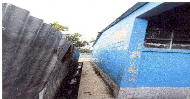
Foto 13: Estado actual de la pintura de paredes de aulas exteriores
