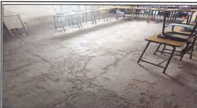
Foto 4: Estado actual piso de torta del aula de Párvulos 3, de 6.90 mts. de largo por 5.75 mts de ancho, igua la 39.675, se aproximó a 40 mts. Cuadrados
