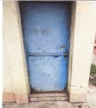
Foto 2: Estado actual de la puerta sin chapa
