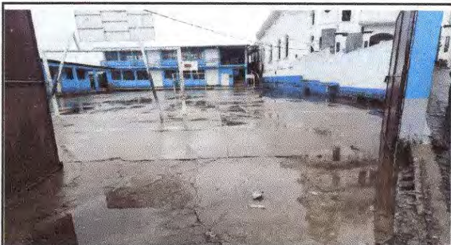
Foto 9: Estado actual de la cuneta donde se reposa agua lado derecho de la cancha de baloncesto
