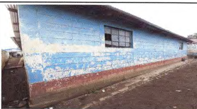
Foto 10: Estado actual de la pintura de paredes de aulas exteriores
