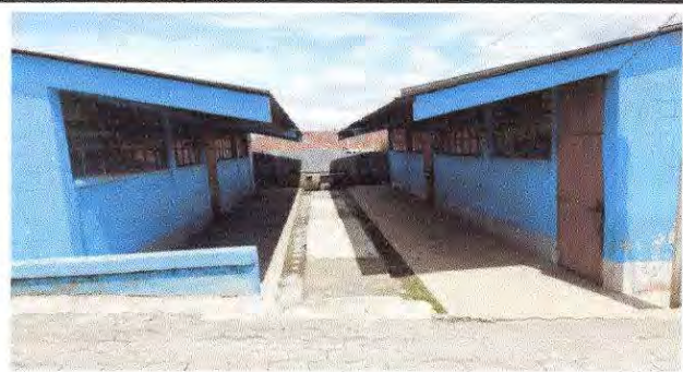
Foto 7: Estado actual, de las goteras de las dos aulas, sustitucion de canal PVC
